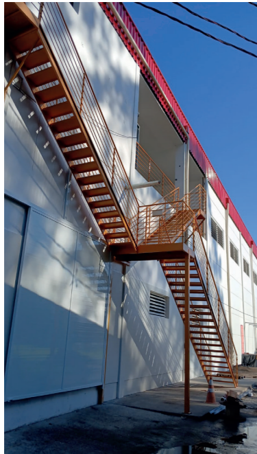
Elevação sala de comando elétrico
