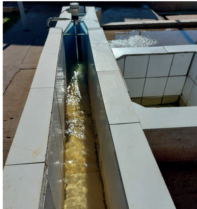
Efluente final tratado
