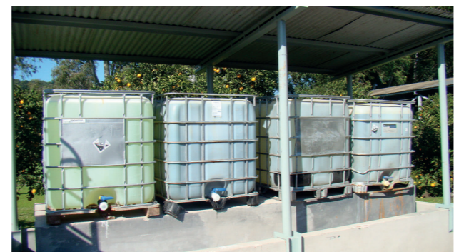
Bacias de contenção
